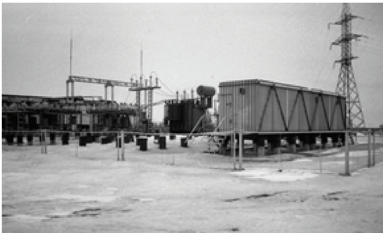
г. Сургут, «Типовая подстанция 110 кВ, у нефтяников для сравнения с Министерством энергетики все тоже, хотя имеется разница в примененном оборудовании и компоновке по релейной защите значительная», 1986 год
