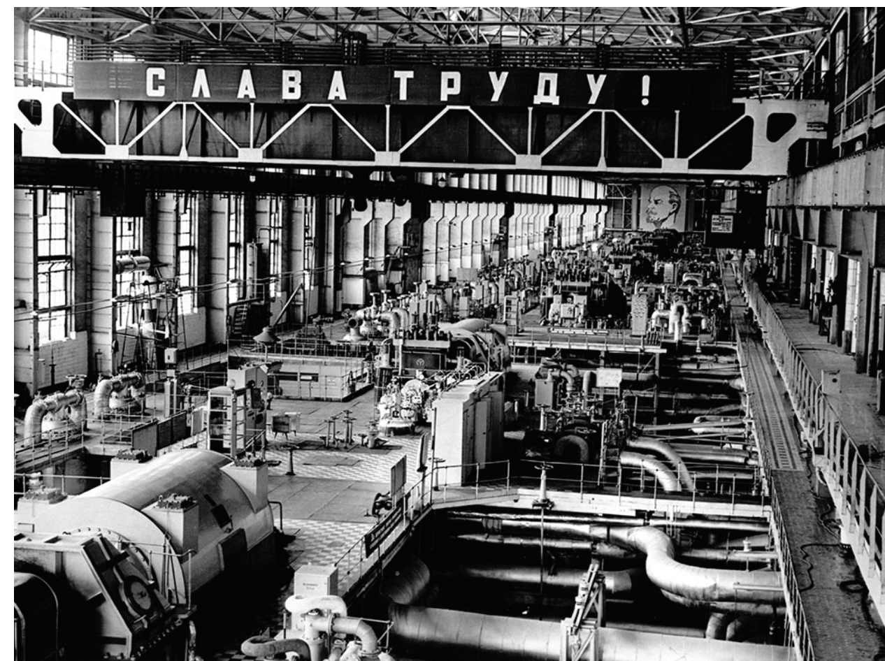
Общий план машинного зала Дубровской ГРЭС «Ленэнерго», 1970-е годы
