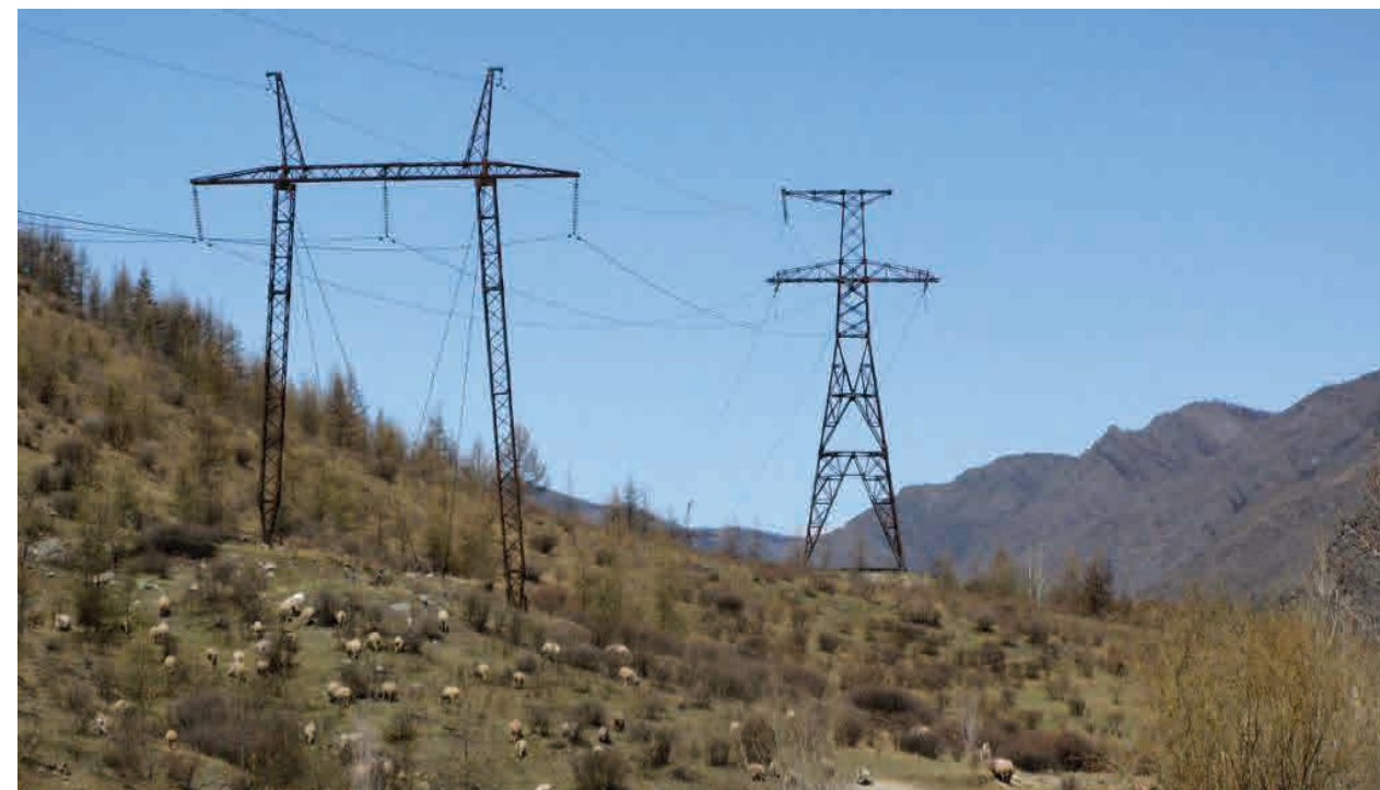
Участок ЛЭП-220кВ Кызыл –Ак-Довурак
